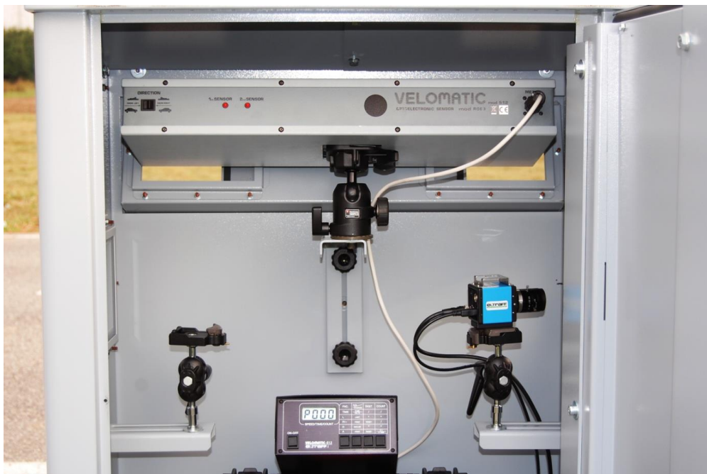
Fig. 10: Posizionamento del sistema di ripresa
